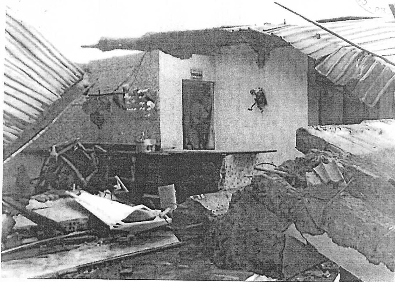
Casa ficou destruída após reservatório de água romper em Jataizinho — Foto: Reprodução/RPC
